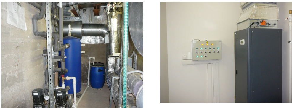
Рис. 4. Оборудование прецизионного кондиционирования помещения рубидиевых реперов частоты
