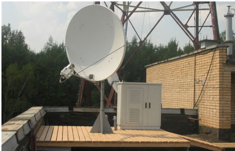
Рис. 3. Станция TWSTFT в ФГУП «ВНИИФТРИ»
